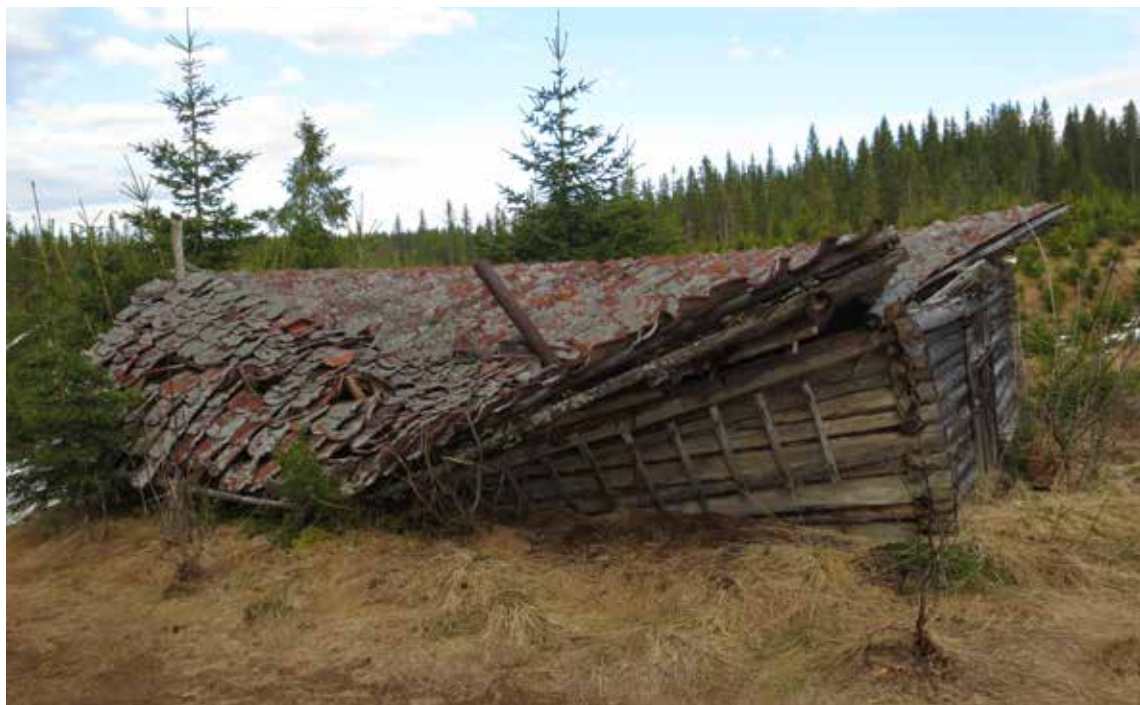
Den fredningsverdige skogskoia Trettehytta i Fluberg vestås var opprinnelig med i kulturminneplanen. Skogshusværet med koie og stall under samme tak er såvidt vi vet unikt på Veståsen - bare denne ene er bevart. Vinteren 2017 la snøen taket flatt. Kulturminneplanen har dessverre feilet i å bevare kulturmiljøet. Foto Bjørn Nystuen 2018.
