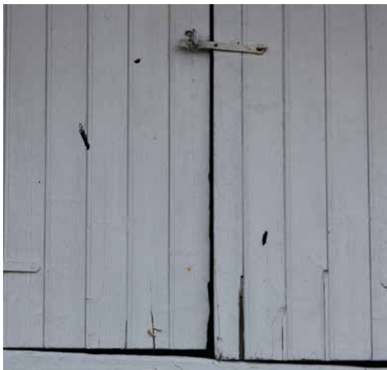
Detalj av låvedøra på Skoglund med spor etter tyske granatsplinter fra trefningen på Haga 22. april 1940. Låven er full av hull.
