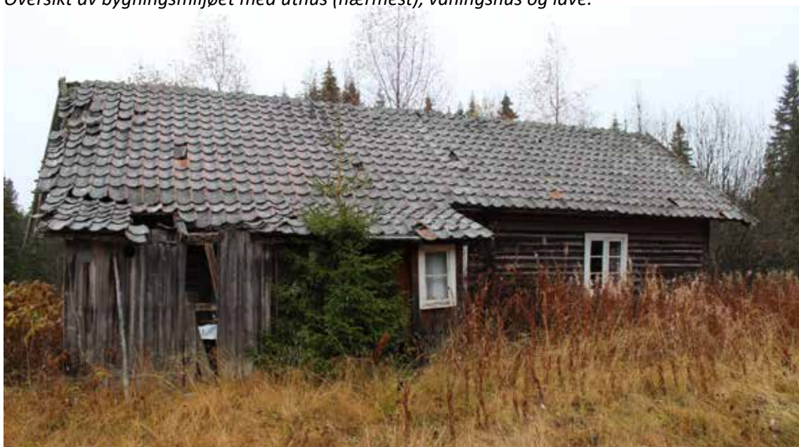
Det fredningsverdige våningshuset er i sterkt forfall, men kan fortsatt reddes.
